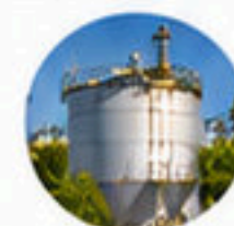
Serbatoi di stoccaggio
